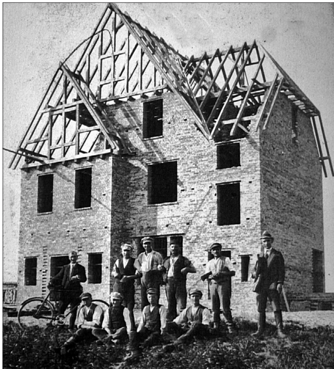
Bild 3 Einer der Bahnhöfe im Rohbau mit Arbeitern im Jahr 1920 (Foto Sammlung Eckehard Schwarz)
