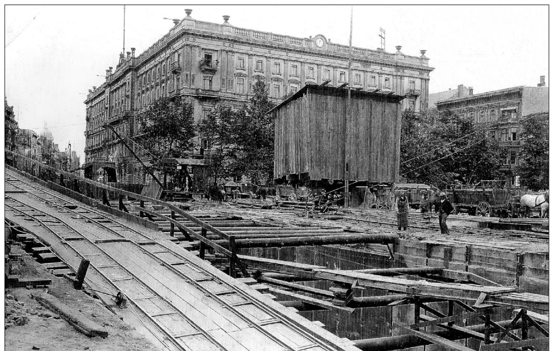
Bild 4 Im Juli 1907 laufen an der Baugrube vor dem Hotel noch die Bauarbeiten.
