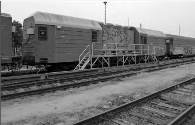
Bild 4 Im Gelände des Werkes Friedrichsfelde ist ein fahrbares Gleichrichter-Unterwerk (fGUw) aufgestellt, das den Fahrstrom für die S-Bahn erzeugt. Hier der Wagen mit den Transformatoren und Gleichrichtern als ein Teil des gesamten Zuges. Das fahrbare GUw soll später von einer stationären Anlage abgelöst werden. (Foto Mike Montana, 5. Juli 2013)
