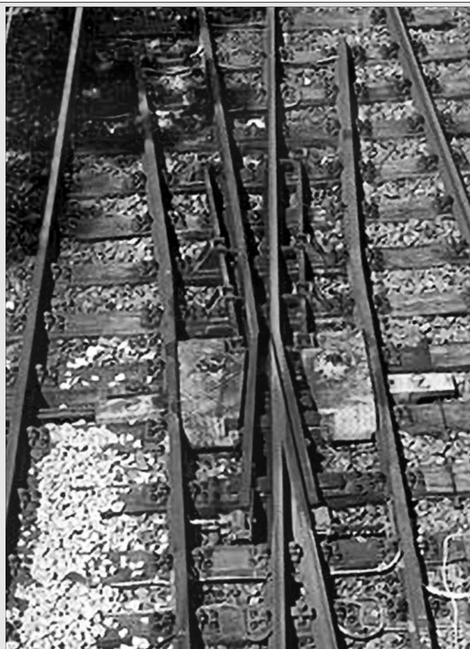
Die „bewegliche Herzstückspitze“ (hier ein Beispiel aus dem Karlsruher Netz) sorgt dafür, dass der Kontakt zwischen Radreifenauflagefläche und Schienenoberfläche nicht unterbrochen wird. (Foto Lutz Habrecht)
